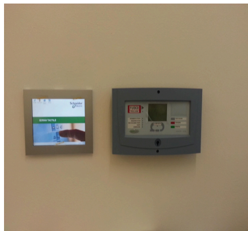
Foto 6: pannello di controllo centrale antincendio presso la bidelleria al piano terra
